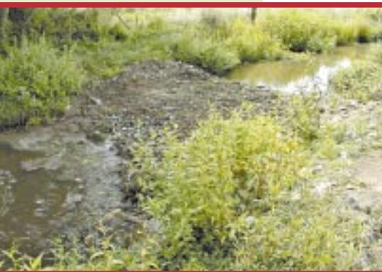
THE NGAROTOITI DIVERSION WEIR
